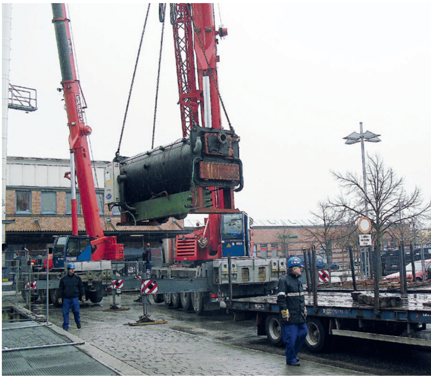
Neue Energietechnik für das Oder-Center: Die Stadtwerke investierten 750 000 Euro, um das Center künftig mit Fernwärme und Gas für die Kälte- und Klimaanlage beliefern zu können.
